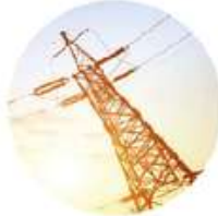
Líneas de Transmisión desde 13 kv a 115 kv
