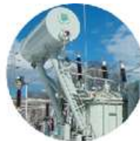
Transformadores de Potencia y tableros de distribución
